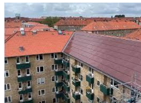
Eksempel på integreret solcelleanlæg med røde solceller
