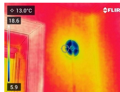
Termofoto af udluftningsventil
