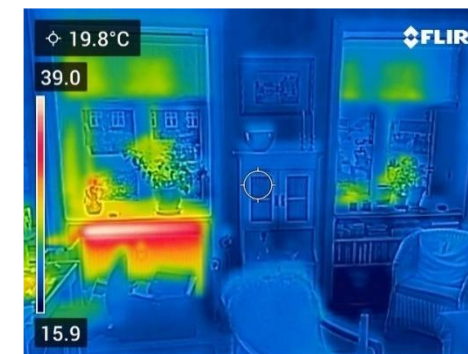
Termofoto af radiator under vindue
