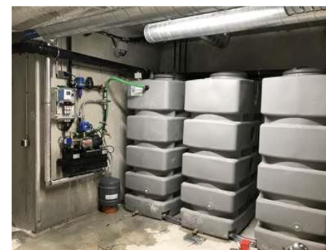
Eksempel på regnvandsanlæg
