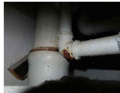
Tæring på vandinstallation
