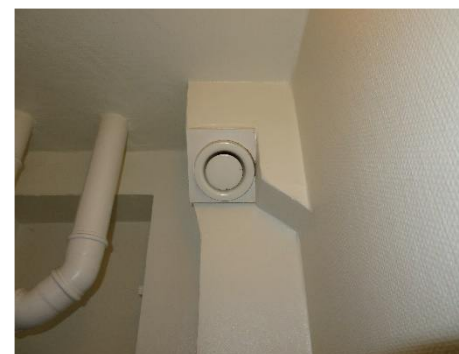
Udsugningsventil i badeværelse
