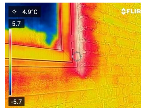
Termofoto af vinduesfuge
