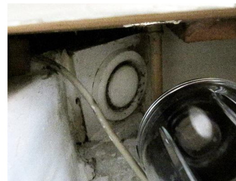
Udsugningsventil i køkken, gemt i køkkenskab
