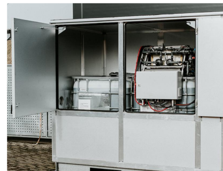
Eksempel på batteri-anlæg
